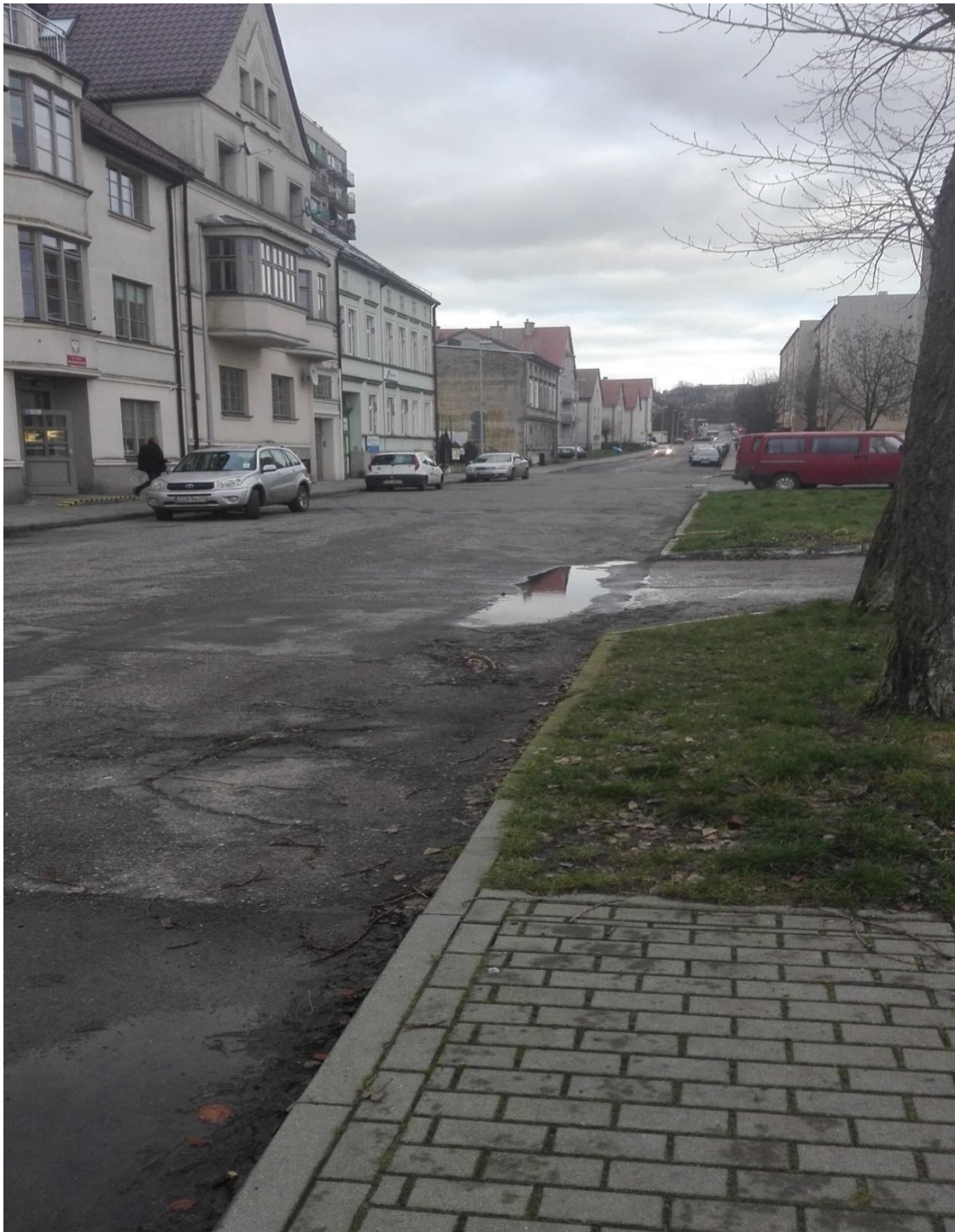
Zdjęcie 8. Stan drogi i chodnika przy zejście na Nabrże od ulicy Tadeusza Kościuszki
